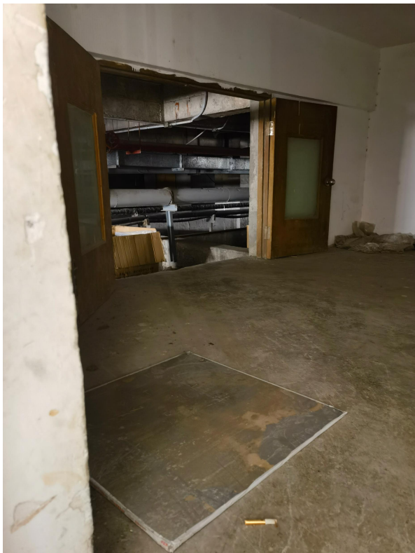
DSA 机房上方设备层
