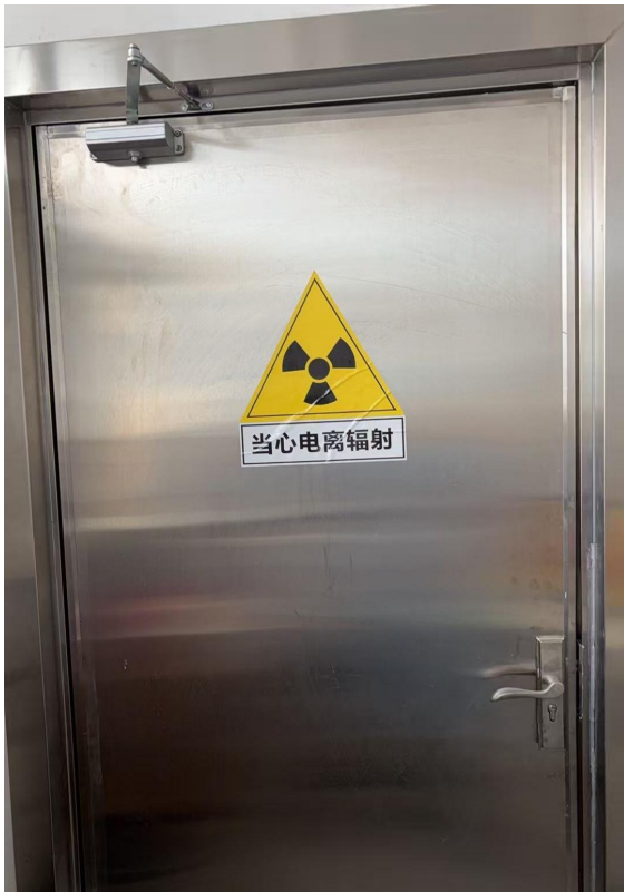
设备间防护门
