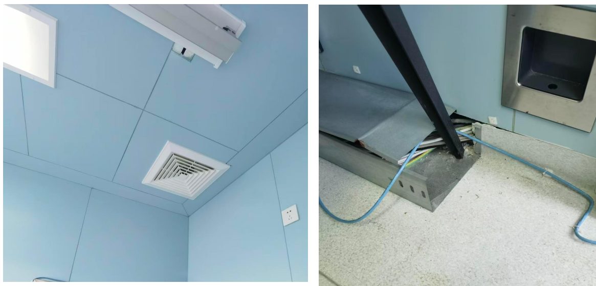
图 3-5 DSA 机房内通风和管线穿墙
